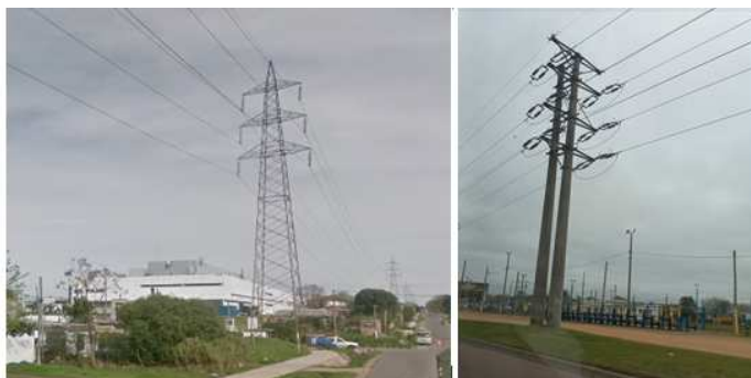
Ilustración V – Ejemplos de líneas de transmisión- T > 66\text{ kV}
