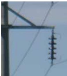
Ilustración II- Ejemplo de una cadena con 5 platos de aislación de líneas de 63 kV.
