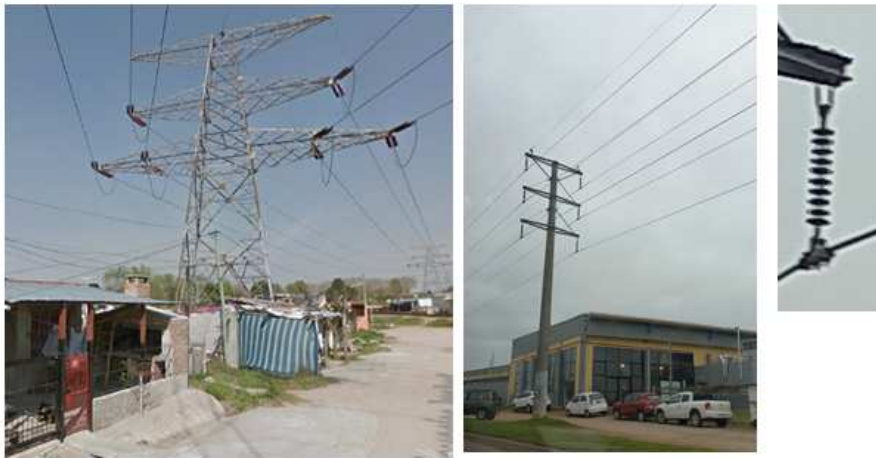
Ilustración IV- Ejemplos de red eléctrica T>66 kV
